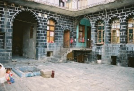
Resim 11. Avlu cephesinde doku bozulması
