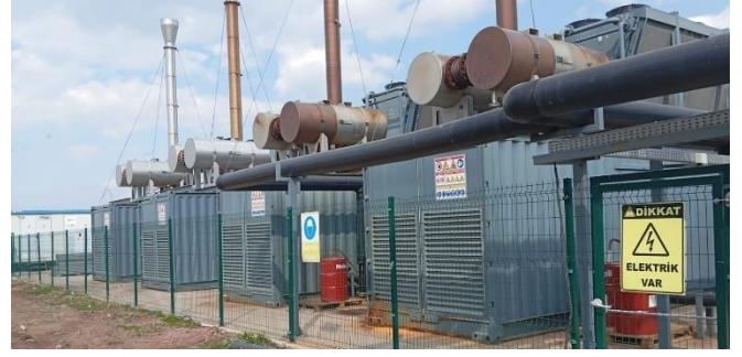
Şekil 10 Elektrik üretim tesisi
