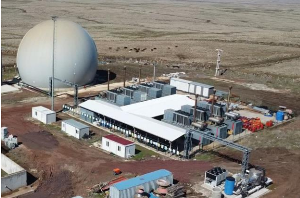
Şekil 7 Tesiste bulunan ünitelerin genel görünümü
