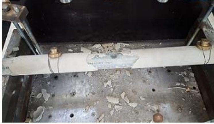
Şekil 8. Göçme hasar durumu
