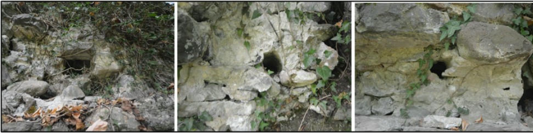
Görsel 26: Güney ve Batı Surdaki Ahşap İskele/Drenaj Boşlukları (E. Verim)
