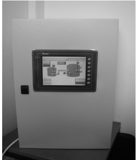
Şekil 4. Biyogaz tesisi operatör paneli
