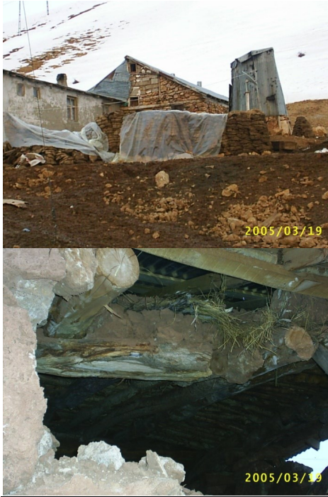
Şekil 4. Moloz taş duvarlı hafif çatılı ile ağır toprak damlı bina örnekleri (Çatak)
