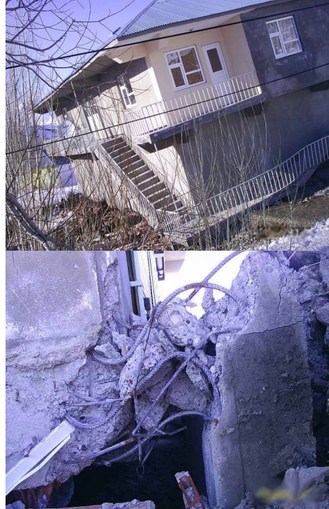
Şekil 3. Karkas kırsal konut örneği olarak bir yapının hasar durumu (Çatak)
