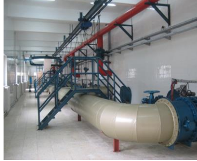
Şekil 14. Filtre boru galerisi
