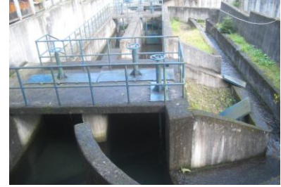
Şekil 3. Ilıca Su alma yapısı
