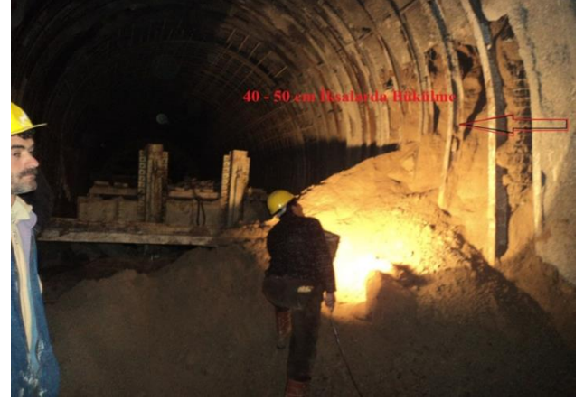
Şekil 9. İksaların yanal basınçlar nedeniyle bükülmesi
