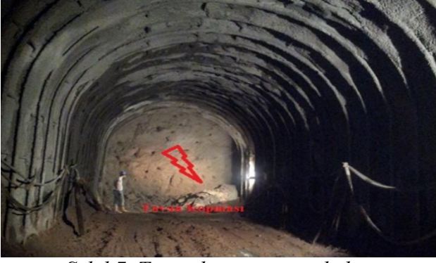
Şekil 7. Tavanda yaşanan sökülme
