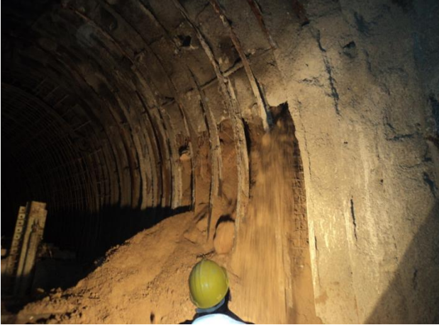
Şekil 8. Yan duvarlarda akmalar
