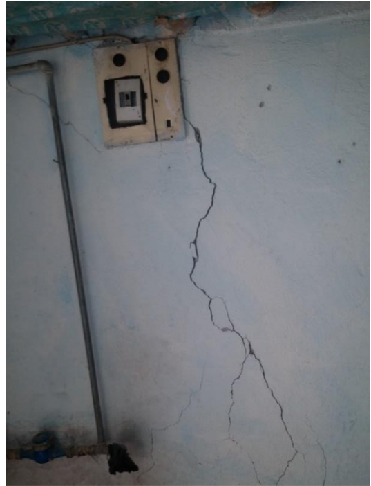
Şekil 16. Boyuna çatlakların içten görünüşü
