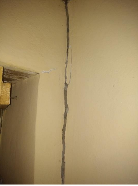
Şekil 6. Birleşim noktalarındaki ayrışma hasarları.
