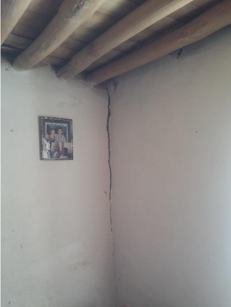
Şekil 14. Bağlantısı yetersiz duvarlardaki boyuna çatlak
