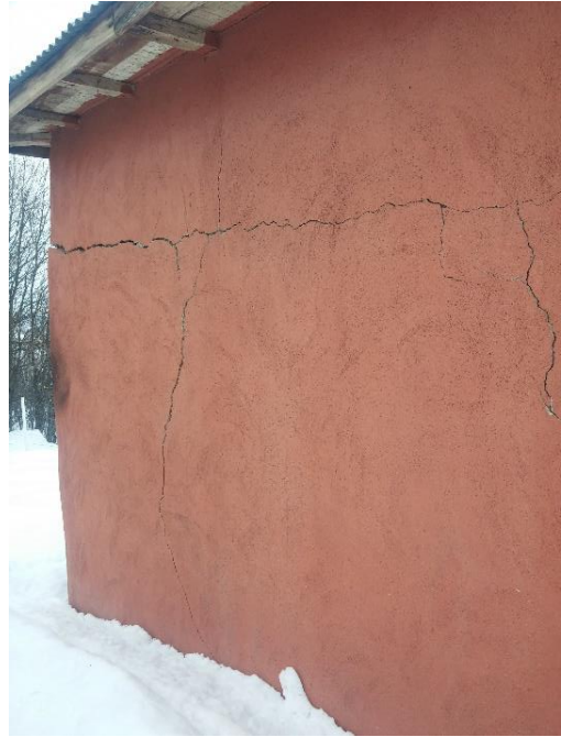
Şekil 11. Hatıl boyunca oluşan çatlaklar
