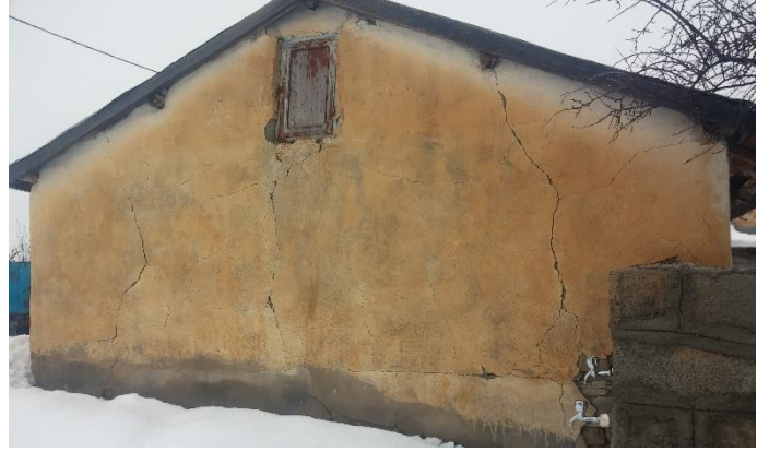
Şekil 15. Hatıl olmamasından kaynaklı boyuna çatlaklar.
