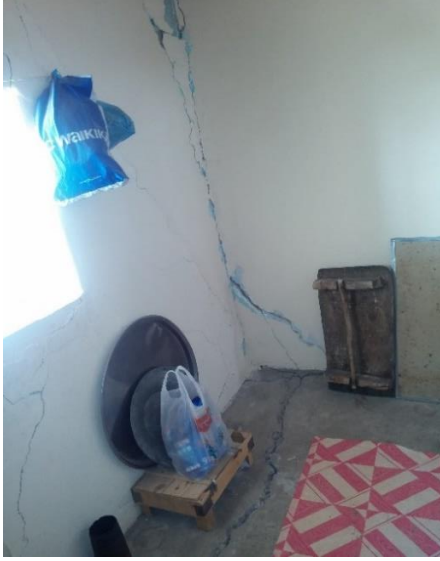
Şekil 9. Duvar ve döşemede oluşan derin çatlaklar
