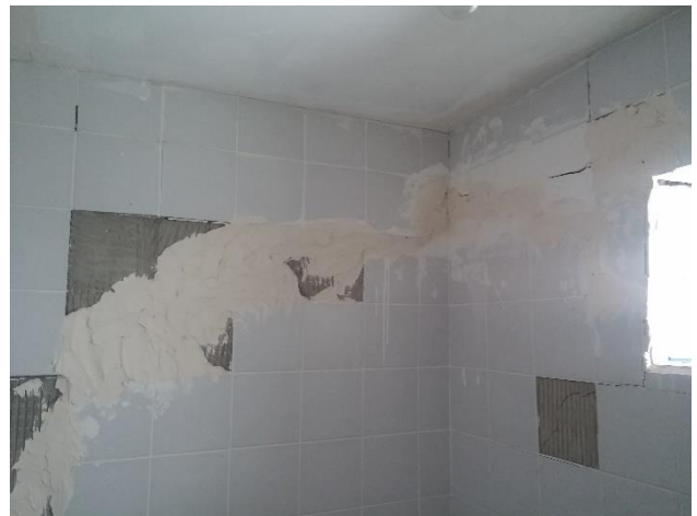
Şekil 12. Düzlem içi ve hatıl boyunca oluşan çatlaklar
