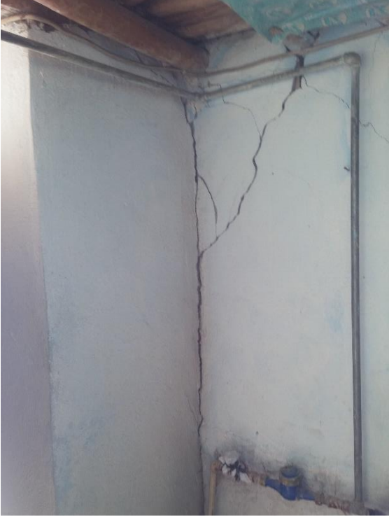
Şekil 13. Köşe bağlantıları özensiz ve kötü yapılmış yığma bir yapıdaki derin çatlaklar
