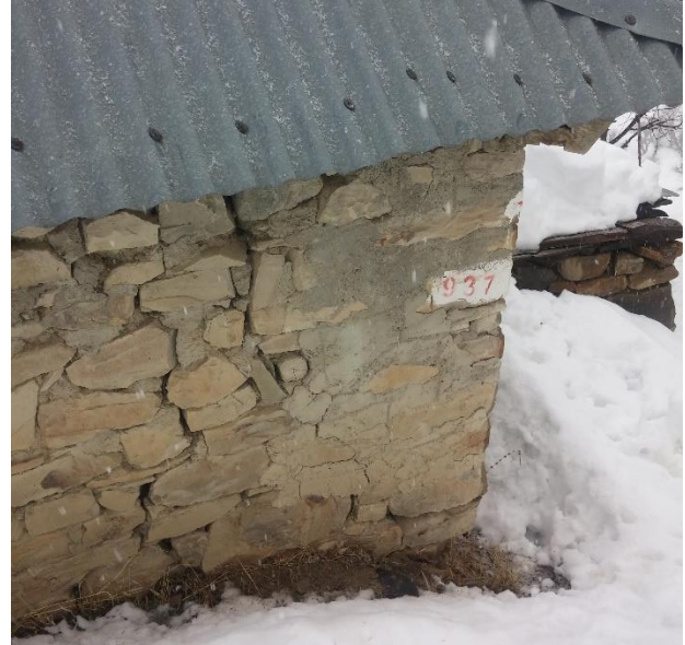
Şekil 8. Eğimli zeminin hareketinden kaynaklı oluşan hasar
