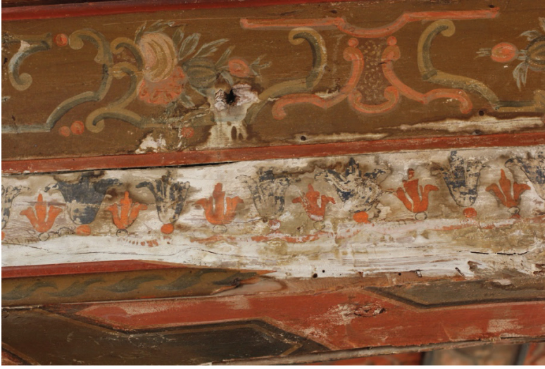
Fotoğraf 20: Tavanda aşınmış bir bölümden ahşap yüzeyinde alçı malzemeyi gösteren fotoğraf (2019)
