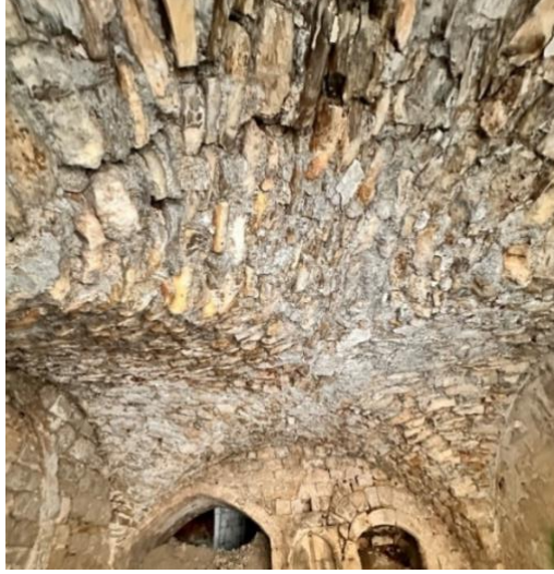
Şekil 21. IIIM13 mekânı tonozunda görülen bağlayıcı malzeme hasarları, © 2024 Çuha.
