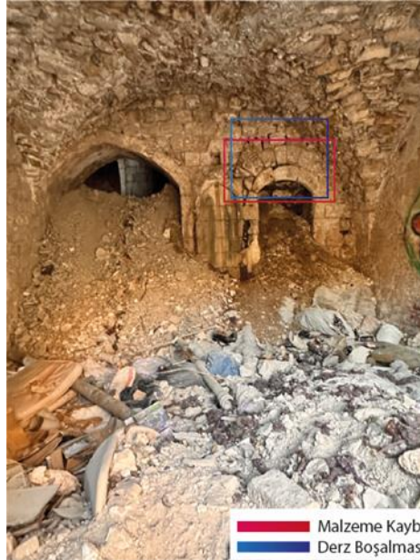
Şekil 17. IIIM13 numaralı mekan ve düşey taşıyıcı elemanlarında görülen hasarlar, © 2024 Çuha.
