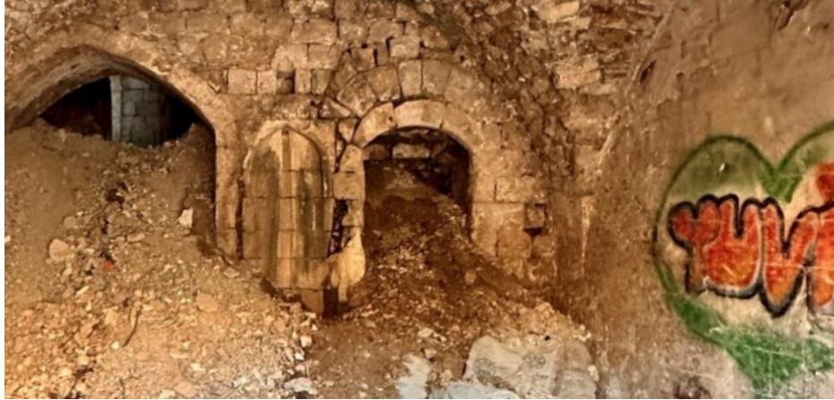
Şekil 22. IIIM13 mekânı pencere kemerinde görülen ayrışma hasarı, © 2024 Çuha.
