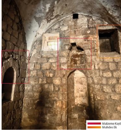
Şekil 19. IIIM1,2,3,4 mekanında görülen derz boşalmaları ve dönem müdahaleleri, © 2024 Çuha.
