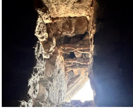
Şekil 28. IIIM14 mekanındaki penceredeki ahşap taşıyıcı elemanlarında görülen hasar, © 2024 Çuha.
