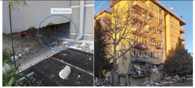
Şekil 5. Kısa kolon ile yumuşak/zayıf kat hasar örnekleri
