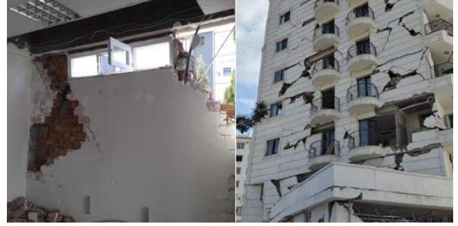
Şekil 9. Betonarme yapılarda dolgu duvarlarda meydana gelen hasarlar
