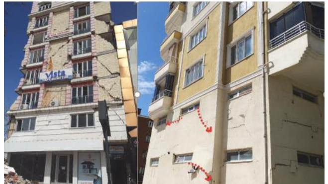
Şekil 7. Ağır çıkma ve pencere boşluklarından dolayı gözlemlenen hasar örneği
