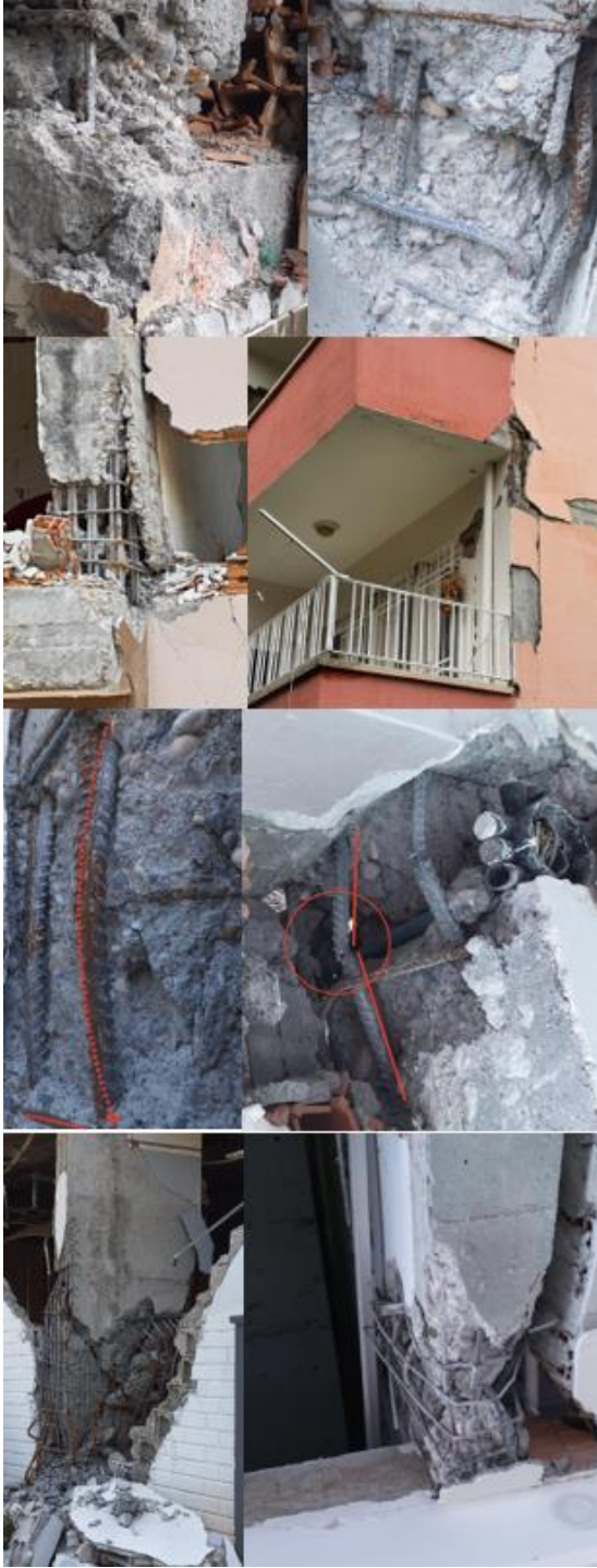
Şekil 8. Beton ve donatı kusurlarından dolayı oluşan farklı düzeylerdeki hasar örnekleri
