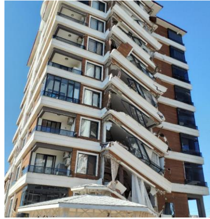
Şekil 6. Yetersiz betonarme çerçeve kenetlenmesi sonucu oluşan hasar örneği
