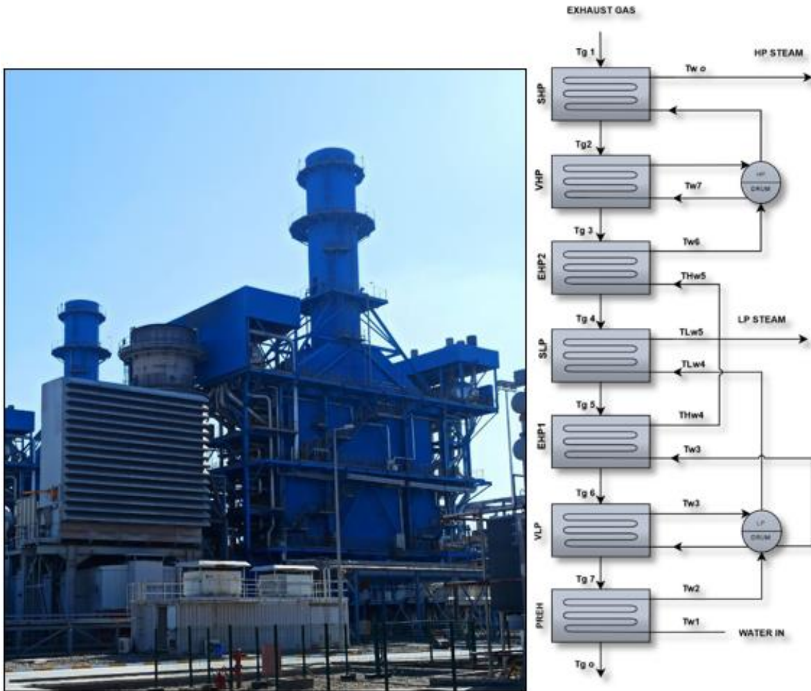
Figure 1. HRSG in Shatt-Al Basra power plant.
