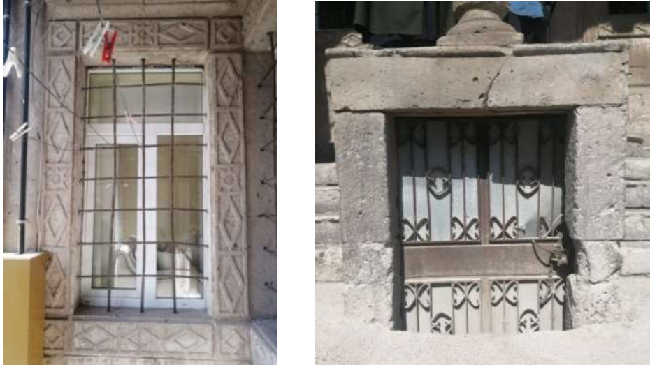
Şekil 13. Hacı Osman Ünsal Evi'nin PVC malzeme ile değiştirilen pencereleri ve giriş kotu altında kalan bodrum kat giriş kapısı (Ata Ünsal vd., 2023: 94)
