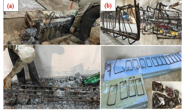
Şekil 6. Yükleme sonrası betonarme kirişlerinin kırılması: (a) beton kırım işleri; (b) betonarme kirişlerinden çıkartılan boyuna ve sargı donatıları
