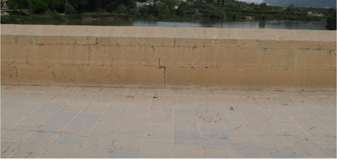
Şekil 17. Korkuluk Duvarlarında ve Yol Kaplamasında Açılmalar 2023 (yazar arşivi)
