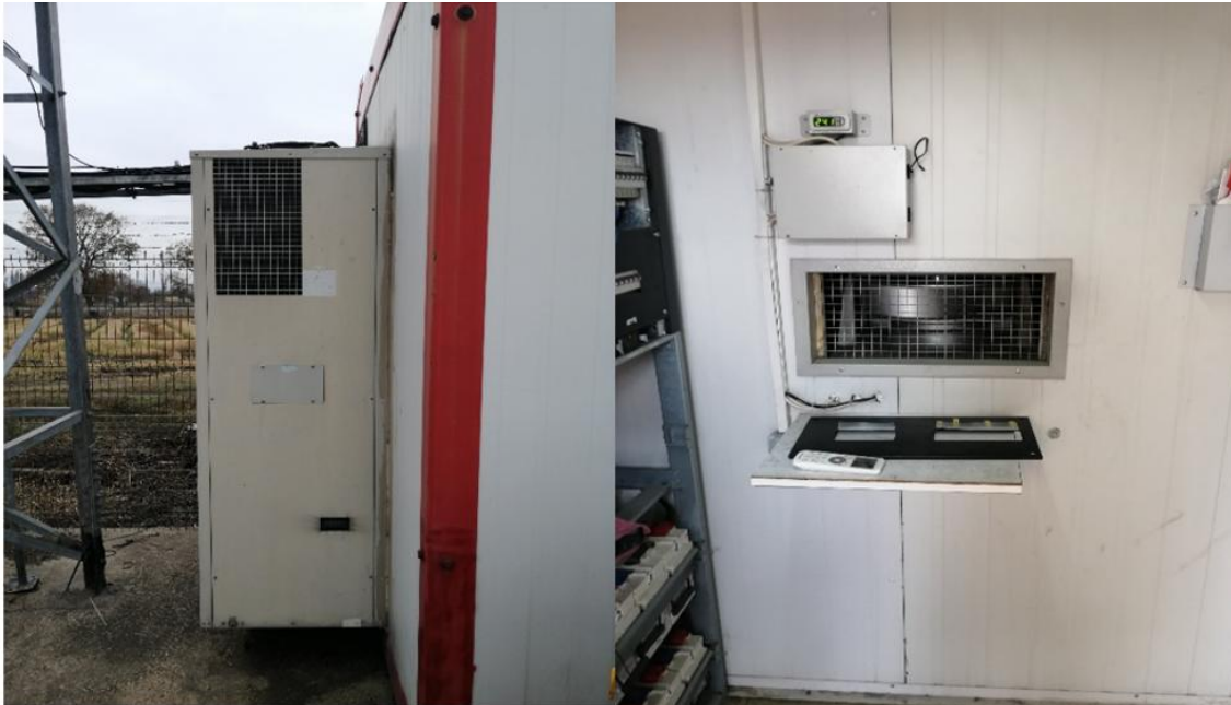
Şekil 9: Doğal havalandırma ekipmanı saha uygulaması
