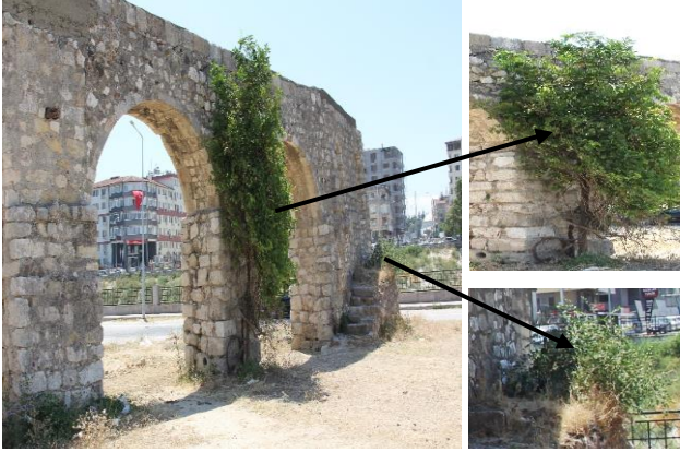
Şekil 9. Alvan Su Kemerî'nde görülen bitki oluşumu. Figure 9. Plant growth in the Alvan aqueduct.
