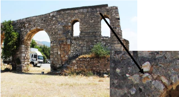
Şekil 6. Alvan Su Kemerli'nde görülen çatlaklar Figure 6. Cracks in the Alvan aqueduct
