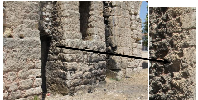
Şekil 4. Alvan Su Kemerli'nde görülen petekgözlülük. Figure 4. Honeycombing in the Alvan aqueduct.
