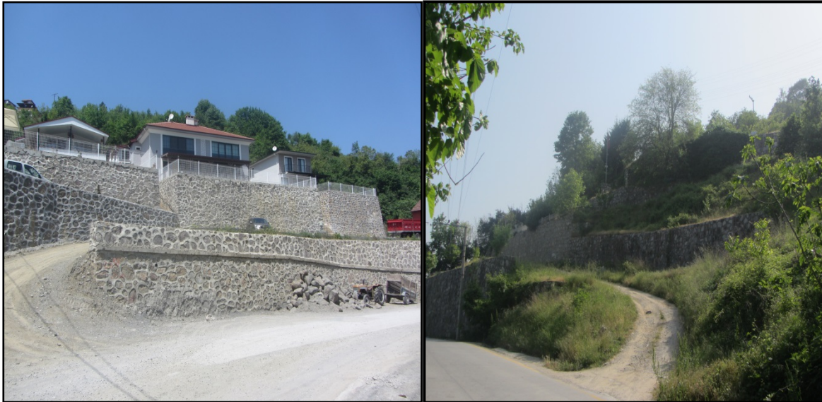
Şekil 12. Heyelanlar sonrası yapılan bazı istinat yapıları. Figure 12. Some retaining structures built after the landslides.
