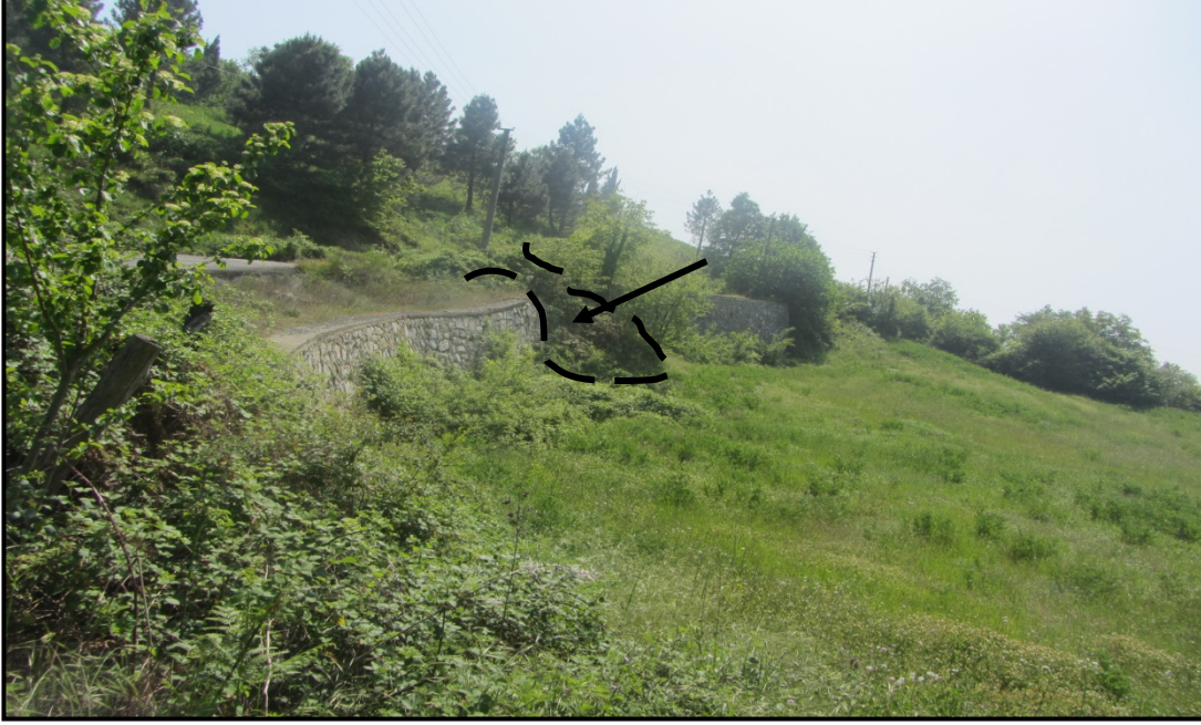
Şekil 9. İnceleme alanında zarar gören istinat yapısı Figure 9. Retaining structure damaged in the study area
