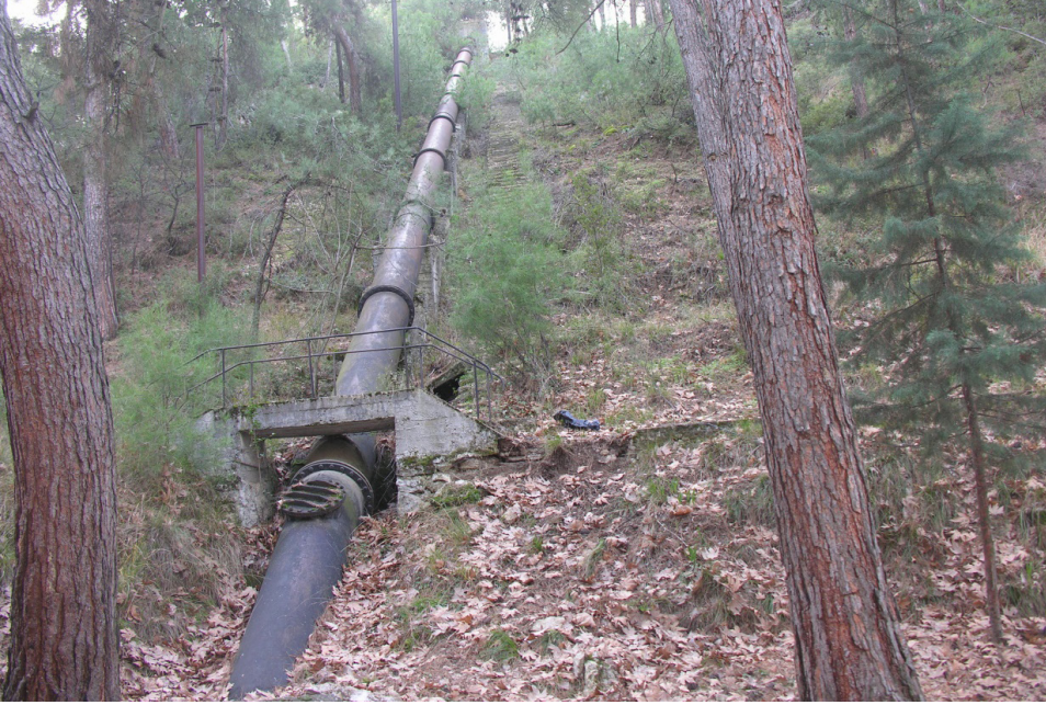
Gökpınar II Hidroelektrik Santrali Cebri Borusu (Aşağıdan Yukarıya Görünüşü) (8 Şubat 2018)
