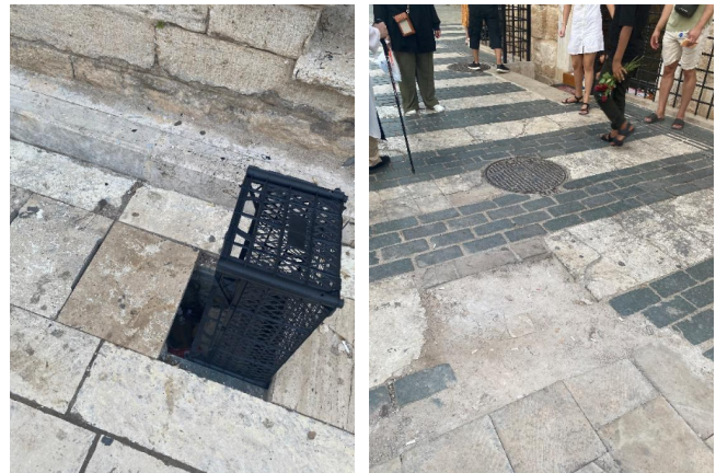
Şekil 10: Kılınçarslan Mahallesi, Kötü Durumdaki Yol Görünümleri
