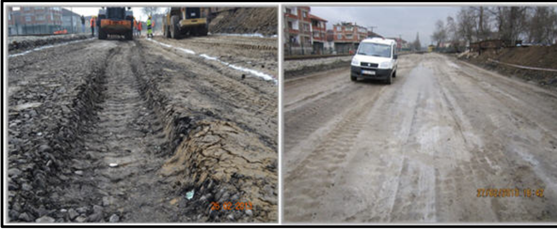
Görüntü 1: Irmak-Karabük-Zonguldak Demiryolu Hattı Rehabilitasyonu ve Sinyalizasyonu Projesi Çaycuma İstasyonu iyileştirme öncesi ve sonrası zemin tabakasının görünümü.
