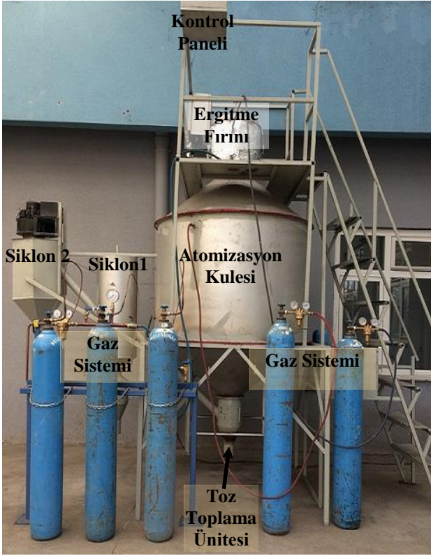
Şekil 2. Gaz Atomizasyon Ünitesi
