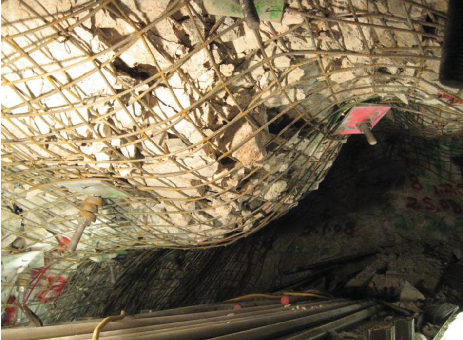
Şekil 1. Kaya patlaması yaşanan bir yer altı açıklığı. Figure 1. An underground opening with rock burst.
