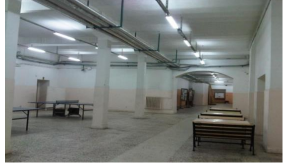
Şekil 7. İlave edilmiş olan betonarme kolonlar
