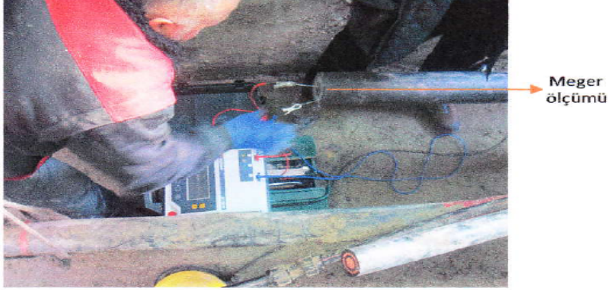
Şekil 12. Yüksek gerilim yeraltı güç kablosuna ait meger ölçümü
