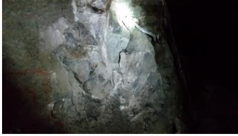
Şekil 5. Galeri yan duvarında oluşan kabarmaya ait görüntü
