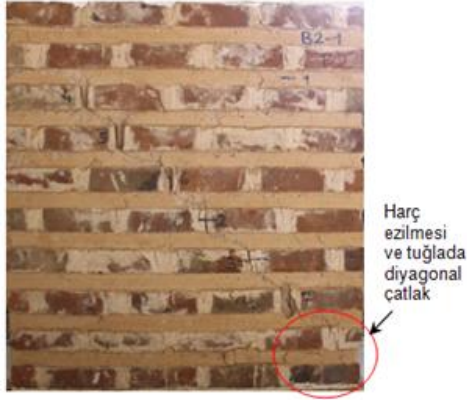
Şekil 19. Deney sonucu mekanizma durumu
