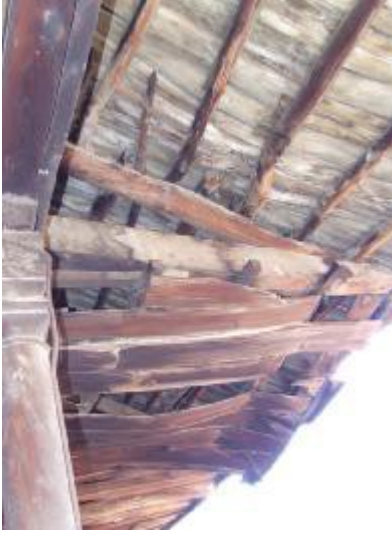
Şekil 9. Ahşap yapı Elemanlarında meydana geldiği gözlemlenen su ve nem etkisi
