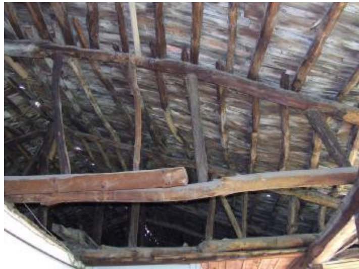
Şekil 10. Çatı konstrüksiyonunda basit işçilik ve düzensiz eleman kesitlerinin de etkisiyle oluşan deformasyonlar
