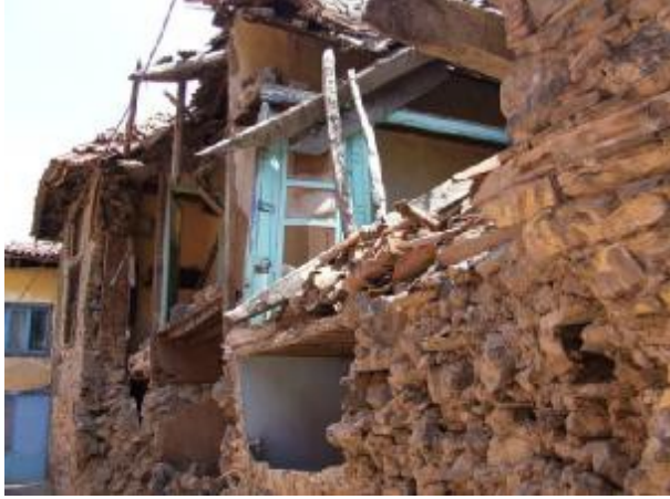
Şekil 15. Resimde iki katlı ve moloz taştan imal edilmiş ve terk edilmiş bir örnek görülmektedir. Yapının döşemeleri ve çoğu yıkılmış olan çatısı da ahşaptır.
