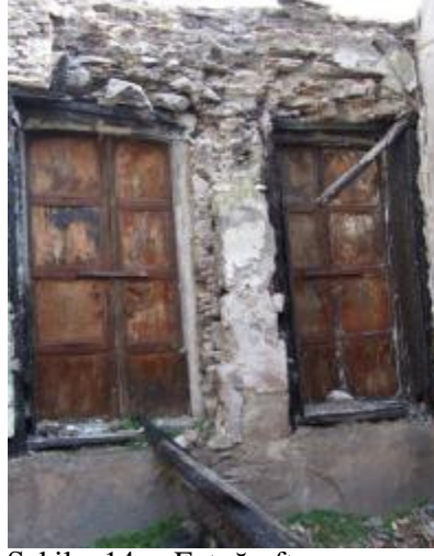
Şekil 14. Fotoğrafta yapının yangın etkisi ile zarar gören ahşap lentoları ve dolayısıyla da yıkılmak üzere olan kargir duvarı görülmektedir.
