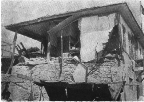
Foto 6 - Amasra'da yıkılan bir ev. Sağlam inşa edilmiş temel duvarları (foto, 3.9.1968 günü saat 12.34 te çekilmiştir).
