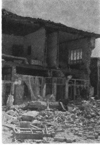
Foto 5 - Amasra içinde yıkılmış bir ev. Yandan gelen sarsıntı (foto, 3.9.1968 günü saat 12.28 de çekilmiştir).
