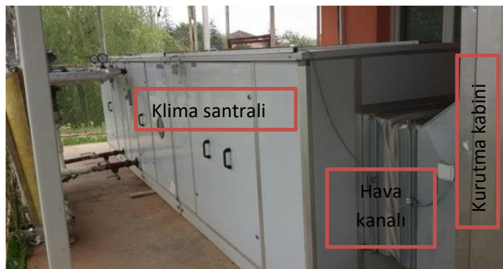
Şekil 1. İşletmede bulunan klima santralinden bir görünüm Figure 1. A view of the air condition unit in the drying plant
