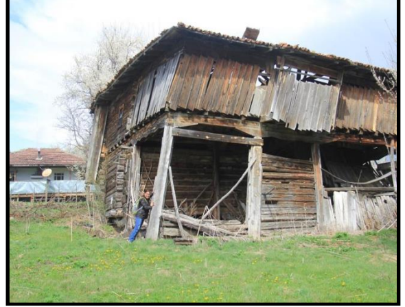
Foto 15. Yapı fiziği bozulduğu için yıkılmak üzere olan bir köy evi (Boyabat)
