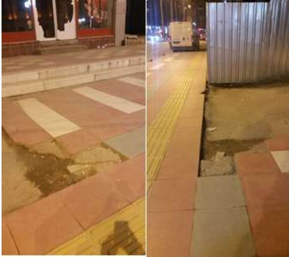
Fotoğraf 15. Çalışma alanında kaldırım döşeme yüzeyinin bozuk/kırık/düzgün olmaması (Ç. B. DİKMEN & Z. ÖZÇETİN Arşivi, 2015)
