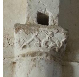
Resim 14: Duvar payesindeki stuko süslemeler
