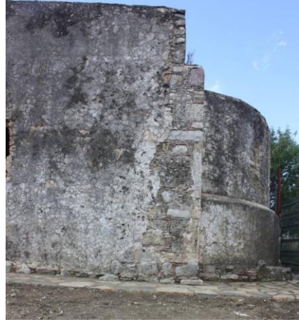
Resim 4: Güney cephede yer alan demir gerginin ucu
