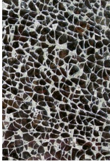
Şekil 16. Temperlenmiş camdaki çatlak oluşumu [46]
