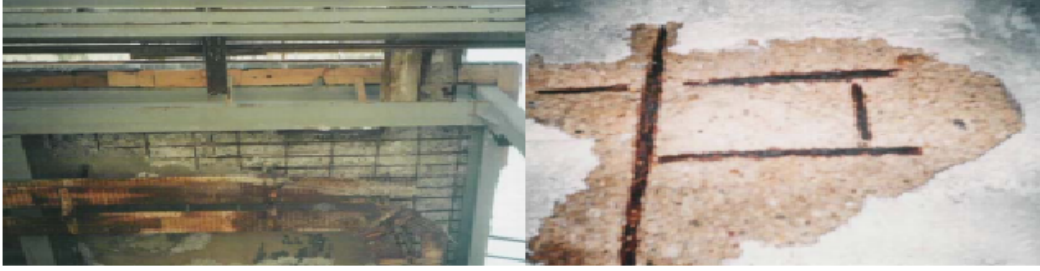
Şekil 7. Denize yakın ortamlarda korozyon hasarları [6]
