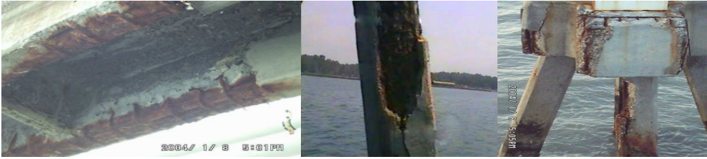
Şekil 5. BOTAS petrol platformunda korozyon kaynaklı meydana gelen yapısal hasarlar [4]
