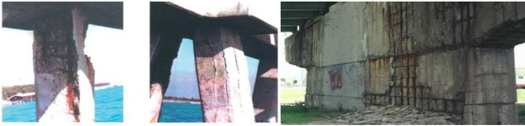
Şekil 4. BOTAS petrol platformunda meydana gelen yapısal hasarlar ve diğer bazı köprü ayaklarındaki hasarlara örnekler [4]
