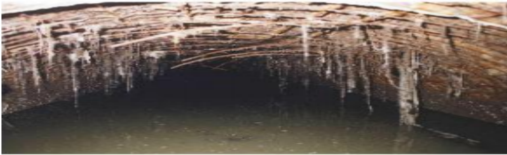
Şekil 6. Atık su ve kanalizasyon sistemlerinde sülfürik asit etkisi sonucu korozyon [5]
