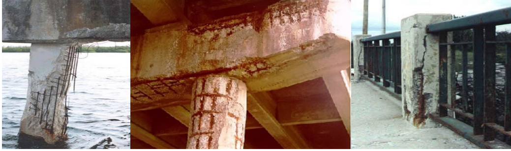
Şekil 3. Çeşitli köprü ayakları ve köprü parapet mesnedindeki korozyon kaynaklı hasar [4]
