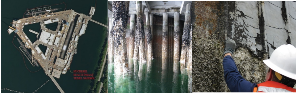
Şekil 8. Denize yakın ortamlarda korozyon hasarları [7]
