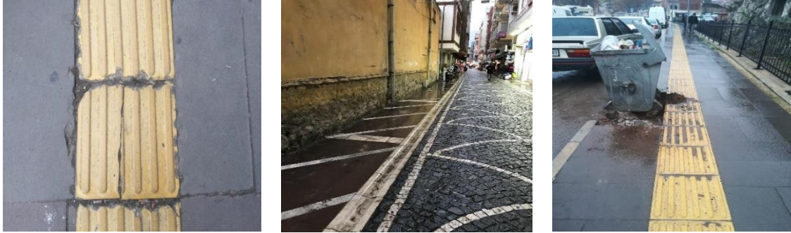
Şekil 4. Duyumsanabilir yüzey deformasyonu (Figure 4. Deformation of strip lanes)
