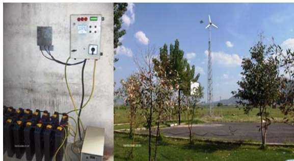
Şekil 3. Kurulu rüzgar türbini ve kontrol ünitesi (Established wind turbine and control unit)
