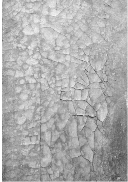
Resim 7: Eskime çatlakları detay çekim
