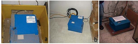
Şekil 2. (a) Montaj planına göre kurulmuş, (b) zemine sabitlenmiş ve (c) poliüretan köpük kullanılmadan montajı tamamlanmış kayıtçı cihazları
