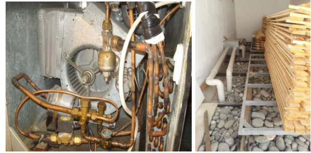
Şekil 4. Nem alma ünitesinin içerisinde sirkülasyon pompası ve evaporatör, Kurutma fırınının iç görünüşü, (Circulating pump inside dehumidification unit and evaporator, Inside view of drying kiln)
