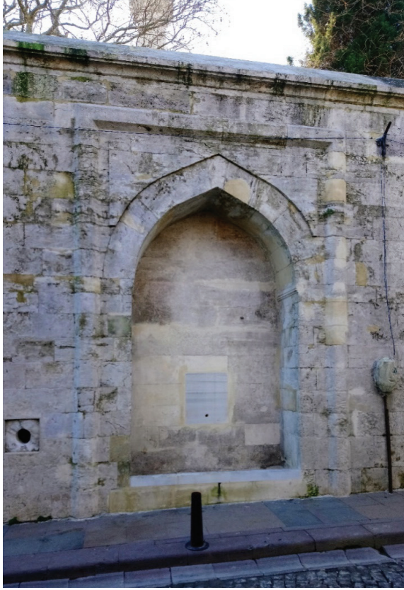
G. 8. İstanbul Süleymaniye Külliyesi, Kuzey Batı Avlu Duvarları Üzerindeki Çeşmesi (N. Ç. Akçıl Harmankaya, 2019)
