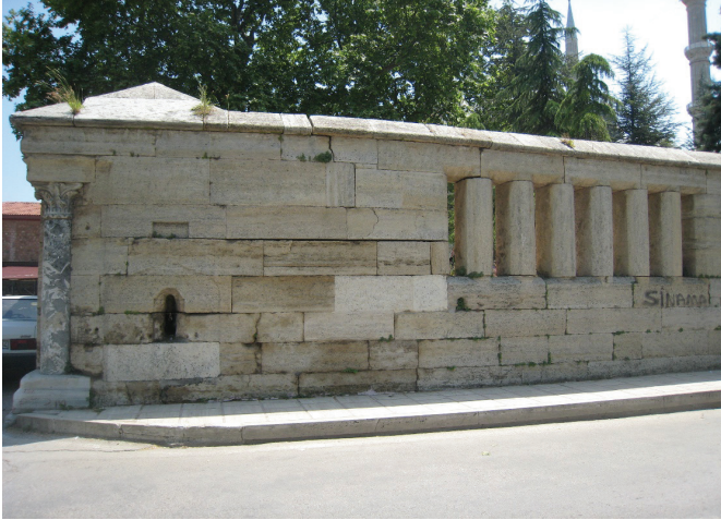
G. 1. Selimiye Külliyesi kuzey cephesi dış avlu duvarları ve çeşmesi (N.Ç. Akçıl Harmankaya, 2018)
