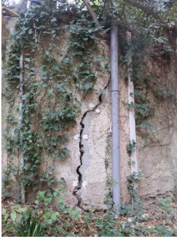
Figür 19. Üç numaralı köşkün istinat duvarında oluşan çatlak.
