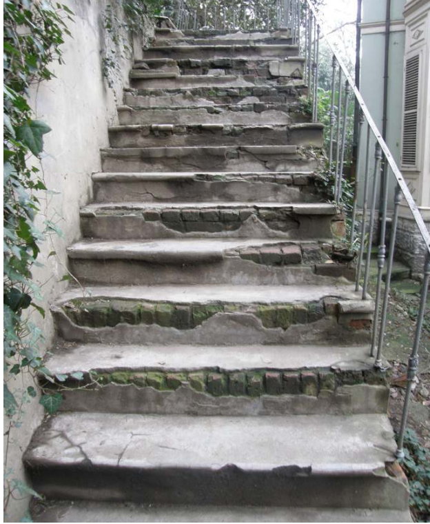
Figür 18. Son dönemde yoğun olarak kullanılan dört numaralı köşkün yanında bulunan merdivenin durumu.
