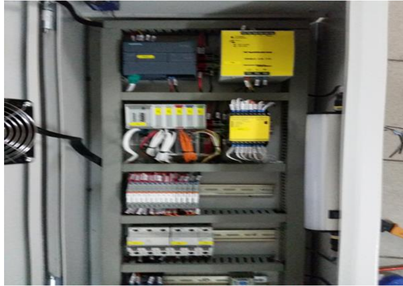
Şekil 3. Hidrolik pres elektrik kontrol panosu
