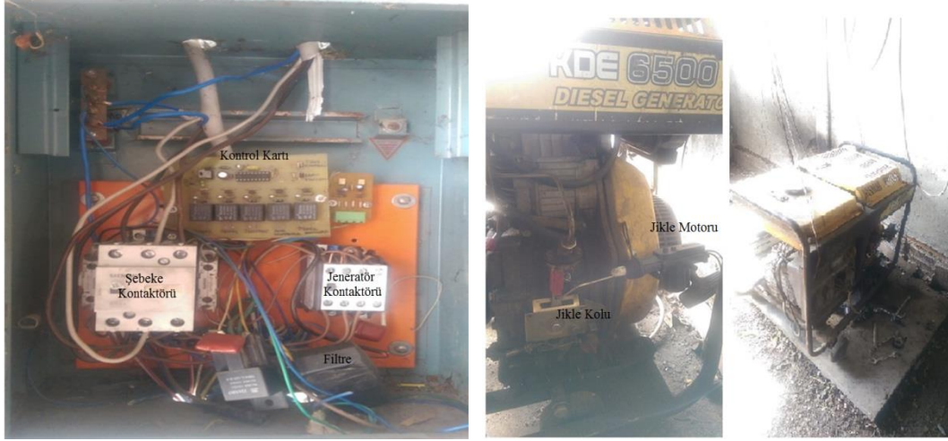
Şekil 10. Uygulaması Gerçekleştirilen Sistem Görünümü
