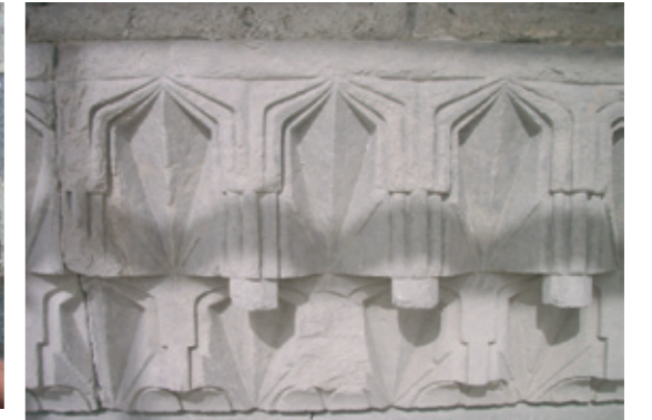
Şekil 30. Şekil 29'daki yüzeyin temizlik sonrası görünümü
