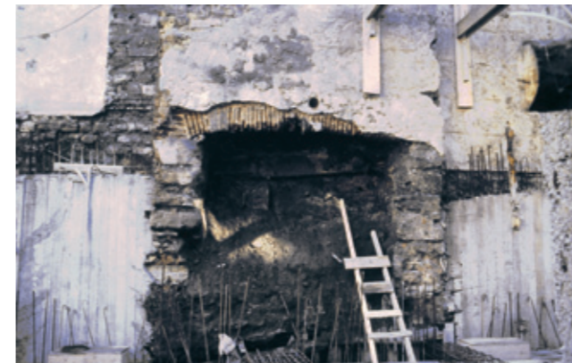
Duvarda özel nokta külhan kapağı
