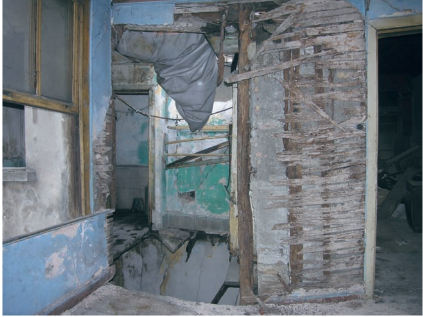
Şekil 3. İkinci kat, 2K04-2K05 mekanlarındaki yapısal hasar
