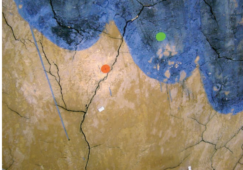
Serafim'de, çimento tabakasındaki çatlaklar
