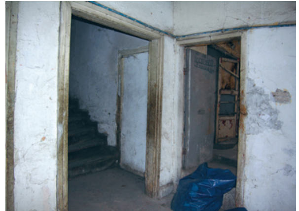
Şekil 8. Zemin kattaki muhdes geçiş ve kapatılan oda giriş kapısı
